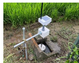
水位センサー及び給水バルブ
