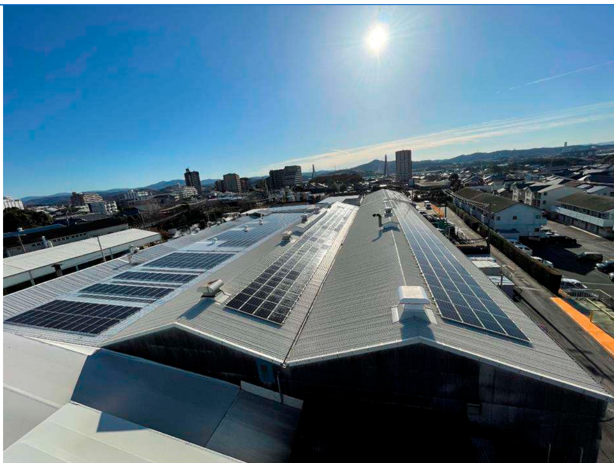
太陽光パネルを設置した工場の例
