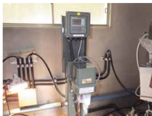
（塩素注入設備）
