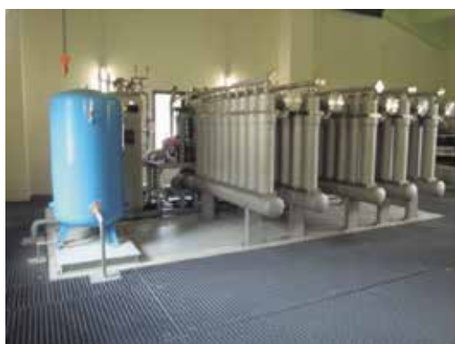
（膜ろ過施設：大沼梶浄水場）
