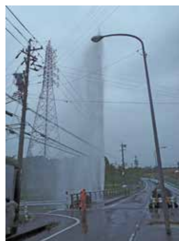
（空気弁破損による漏水）
