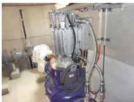
（小水力発電 高岡配水場）
