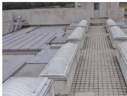
（急速ろ過池の覆蓋）
