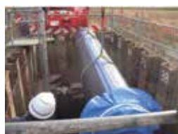
(管路の耐震化)
