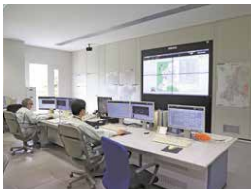
（水道施設の監視）
