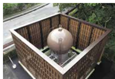
（飲料用循環式耐震性貯水槽）
