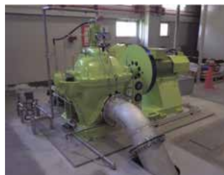
（省エネルギー配水ポンプ）
