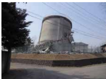
（東日本大震災による配水池の被害）
