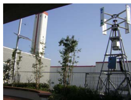
eco-T の風力発電設備
