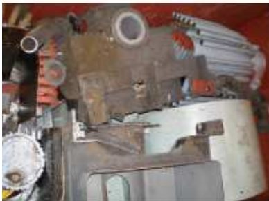
洗浄処理が完了したトランス缶体
